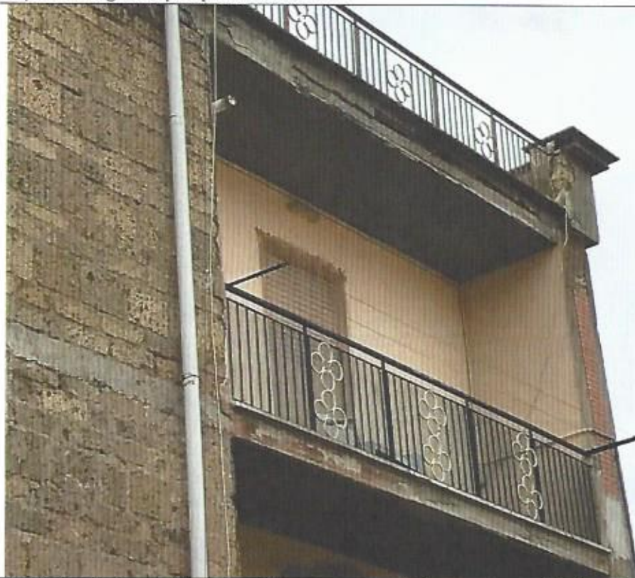
Particolare balcone e degrado della muratura e solaio sovrastante il balcone
