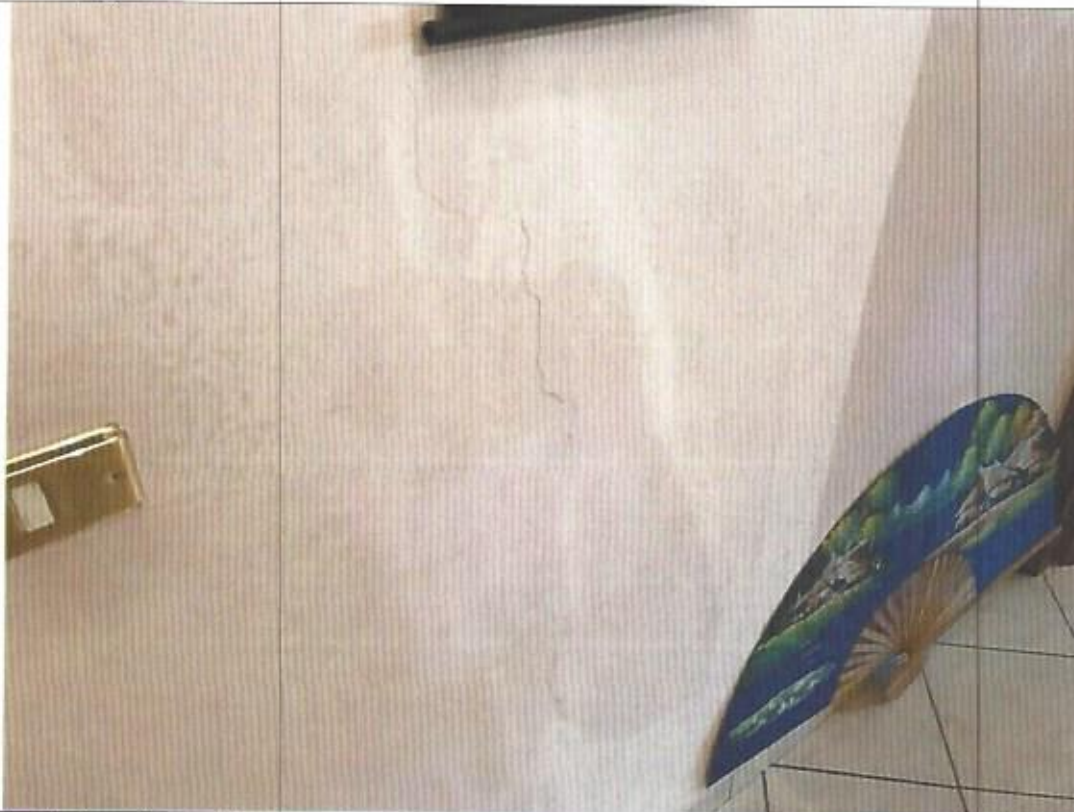
Particolare danni al disimpegno
